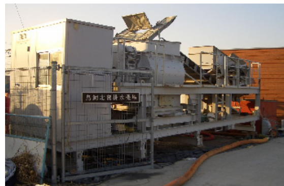
写真-1 充填土砂前処理設備
