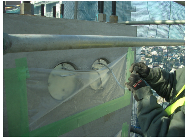
写真-11 グラウトの漏れ養生
