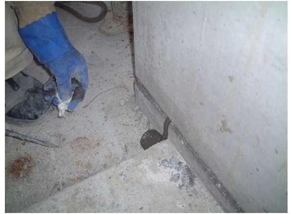
写真-15 エアー抜きモルタル流出状況
