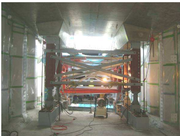
写真-15 水平反力荷重装置
