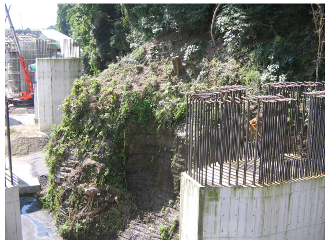
写真-2 崖部の迫り出し(施工前)
