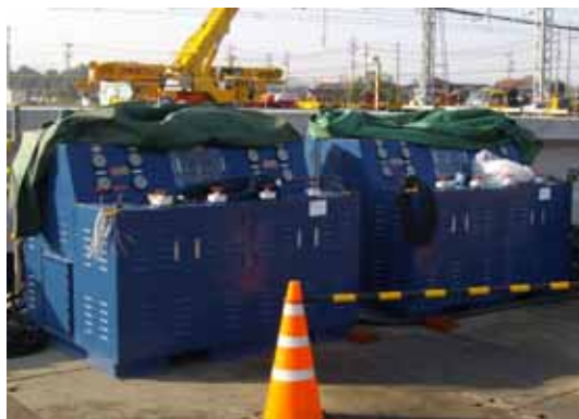
写真 - 3 ポンプユニット
