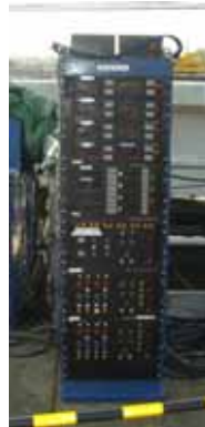
写真 - 4 制御装置
