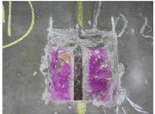
写真-1 鉄筋の腐食と中性化深さ
