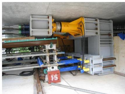
押し出し装置(反力集中方式)
