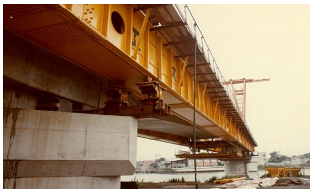
橋脚上の架設桁の支持装置
